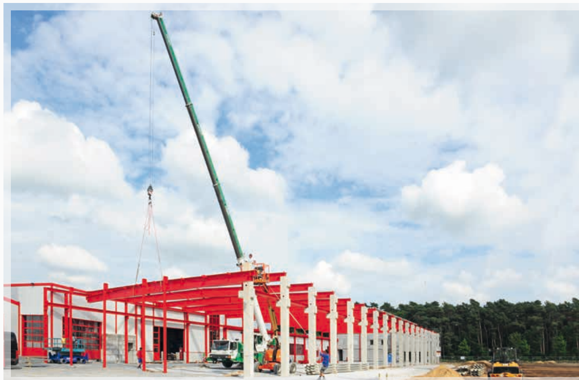
Der Hallenneubau begann im Sommer 2013 und bereits im Frühjahr 2014 konnte die Produktion in den neuen Räumlichkeiten starten. In der 2.250 m 2 großen Halle hat auch das neue Fertigteile-Lager seinen Platz gefunden.
